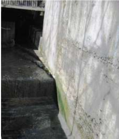
Figur 3-14 Kloakken renner fra et løsnet rør i det nedlagte overløpet.
