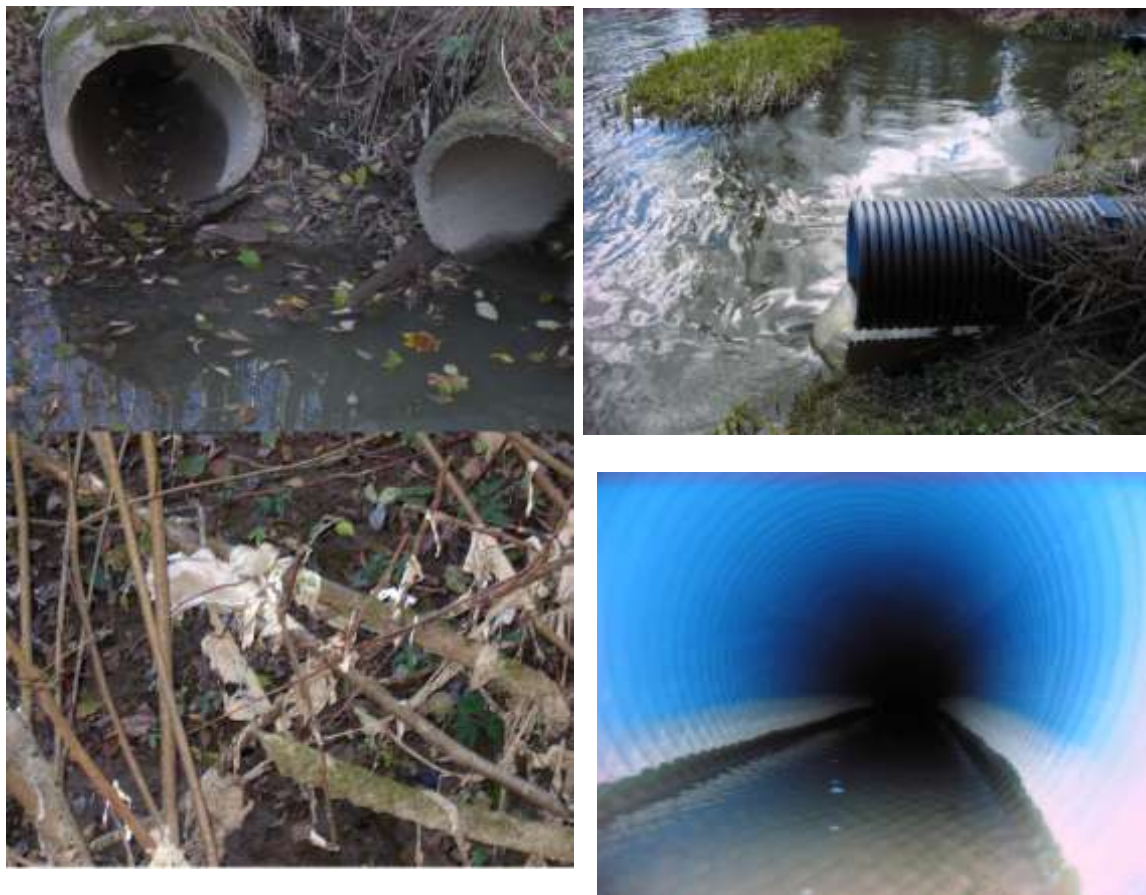
Figur 3-38 Overløpet i Rettenveien. Til venstre 2007, til høyre 2010. En kan merke seg hvor skinnende rent det nye røret er.
